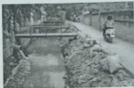
Mương thoát nước
